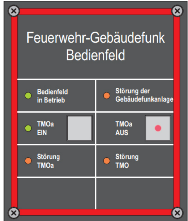
Beispiel TMO/TMO-A Anlage
